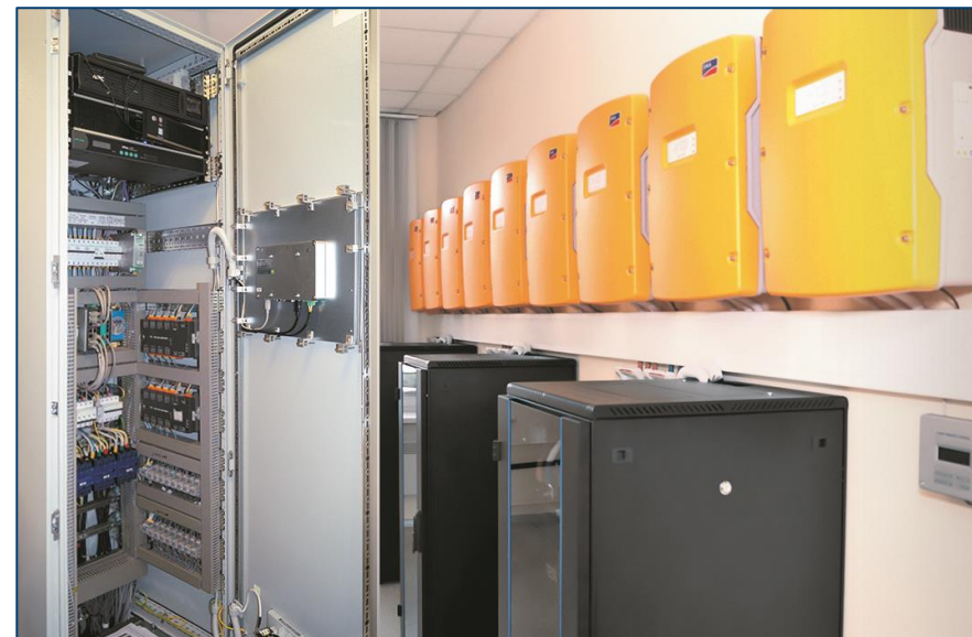
Литий-ионная СНЭЭ (54 кВт / 67,2 кВт·ч) Накопители энергии – TESVOLT TS25 Инверторы – 9 x Sunny Island 6.0H
