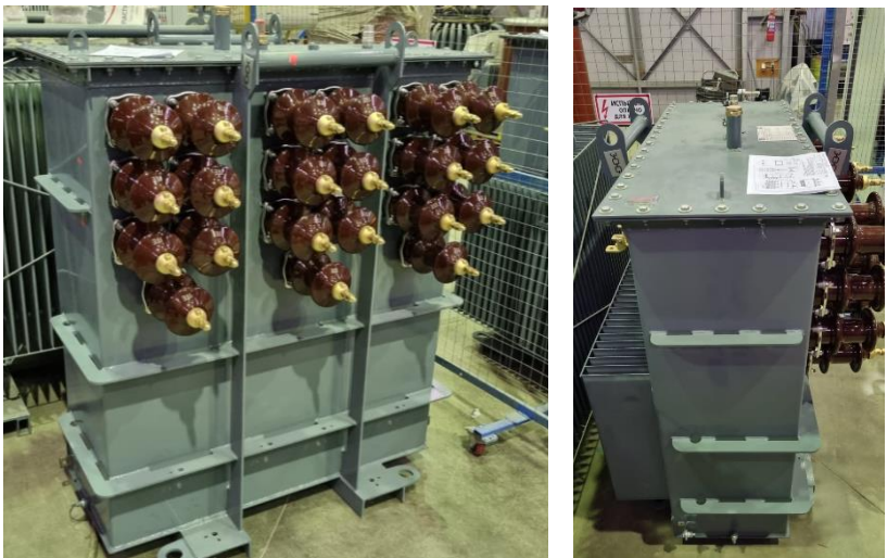
Трансформатор масляного типа 1МВА с внешними выводами ПБВ
