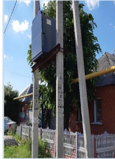
ОПЭ трехфазного ТТРН-Б-100/0,4-3 на объекте Белгородэнерго
