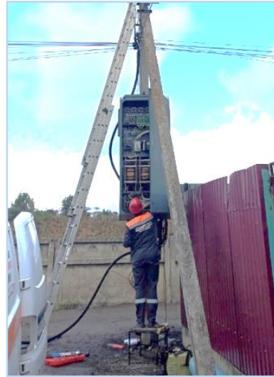
ОПЭ трехфазного ТТРН-Б-100/0,4-3 на объекте АО «ОЭК»
