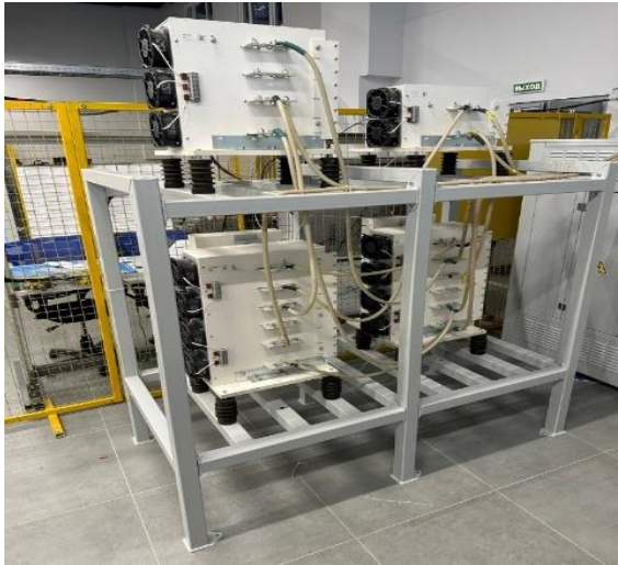
Тиристорный коммутатор 1 МВА
