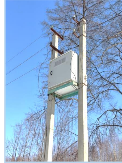
ОПЭ трехфазного ТТРН-Б-100/0,4-3 на объекте Ярэнерго
