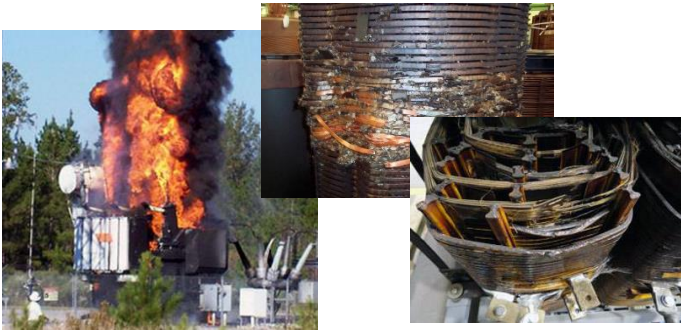
Рис.2 - Последствия витковых замыканий:
