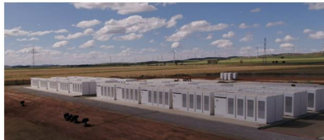
Внешний вид накопителя Tesla энергоемкостью 50 МВтч в Австралии
