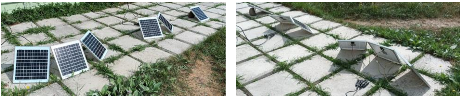
Дугообразное размещение фотоэлектрических панелей
